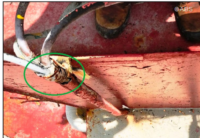
Conduit pipe corroded
